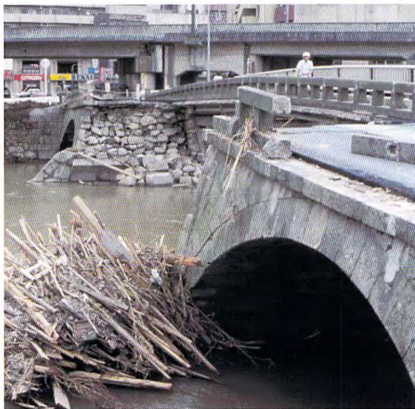
無残な姿になった新上橋
